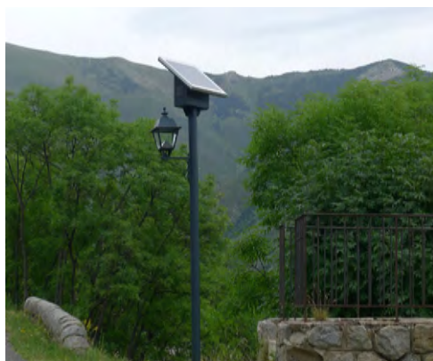
Lampadaires à énergie renouvelable dans les Garrotxes
